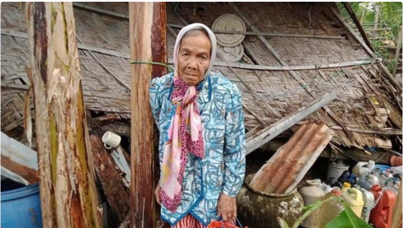
Nenek Malang (70) yang tinggal di sebuah Rumah Tidak Layak Huni (RTLH) di Dusun Baji Pamai, Desa Punagaya, Kecamatan Bangkala, Kabupaten Jeneponto, Sulawesi Selatan (Sulsel).
